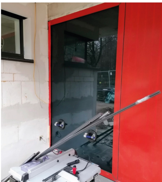
Getöntes Grauglas mit schaltbarer Funktion, hier wurde dieses für ein Unternehmerhaus in Detmold im Eingangsbereich installiert.
